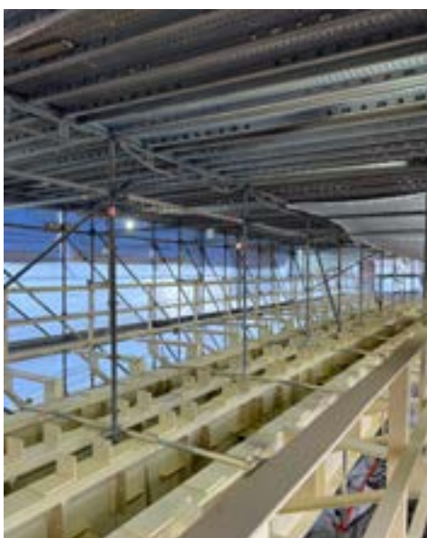
Blick hinter die Kulissen: Die Gossambachbrücke war zu diesem Zeitpunkt bereits sandgestrahlt und grundiert.
